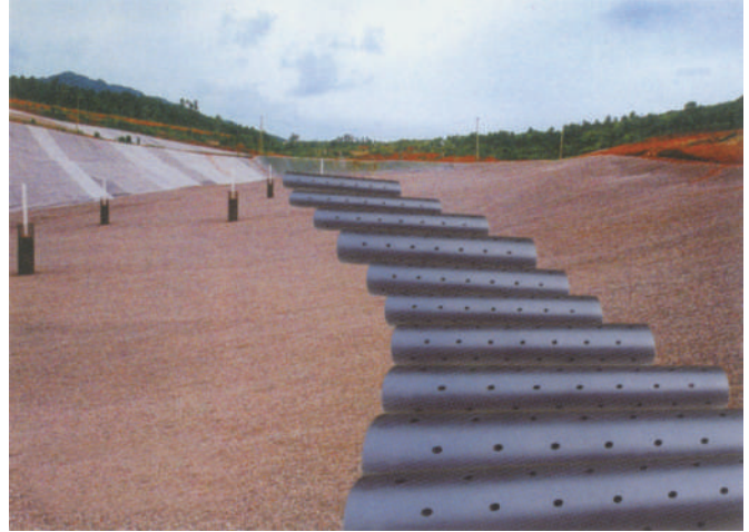
贵州六盘水垃圾填埋渗漏液收集管
